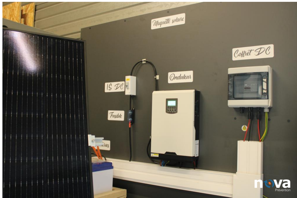
Equipements électriques Panneaux Photovoltaïques
